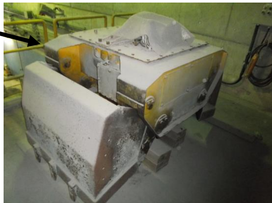
灰クレーン（予備機）
